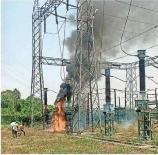
भौखरी 220 लाइन का सीटी ब्लास्ट होने से लगी आग • शोकिताब
